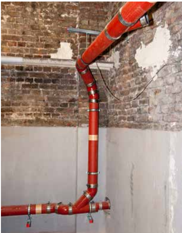
Abgehängte Leitungen an der Kellerwand
