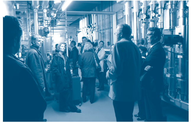
Abbildung 2: Besuch der Technikzentrale des IKMZ an der BTU Cottbus
