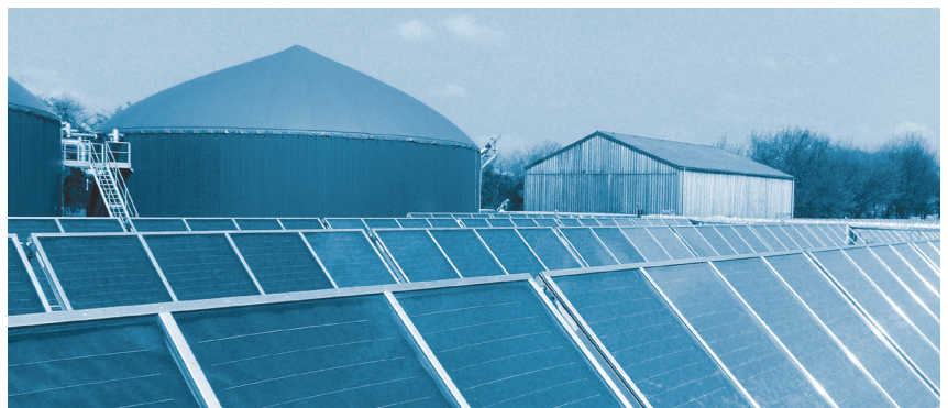
Abbildung 16: Thermische Solaranlage der Stadtwerke Wanzleben, Quelle: Stadt Wanzleben
