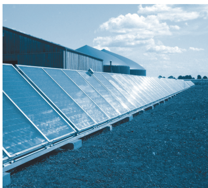
Abbildung 18: Solarthermieanlage Foto: Stadt Wanzleben
