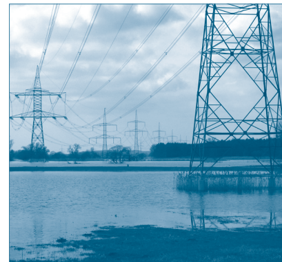
Hochspannungsleitung in der Elbe
