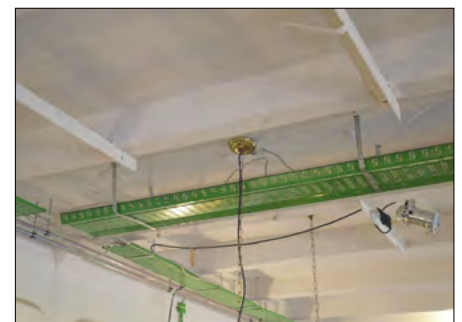
Offen verlegte Elektroinstallationen als Gestaltungselement
