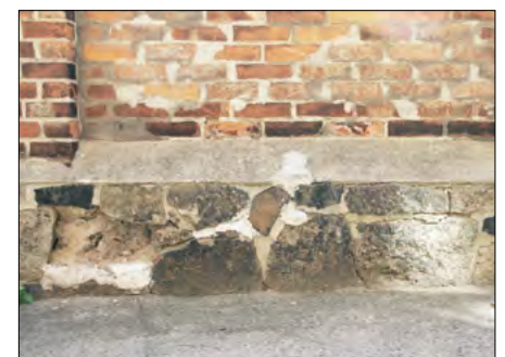
Natursteinsockel mit geschädigter Verfugung (teilweise ausgebessert) und herausgesprengten Bruchsteinen
