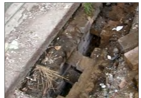
Geöffnete, marode Vormauerung vor der eigentlichen Kelleraußenwand
