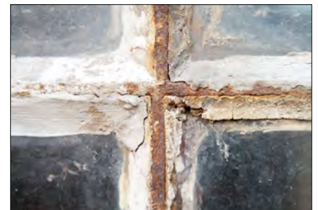
Defekte Verkittung und rostender Stahlrahmen bei fehlendem Anstrich
