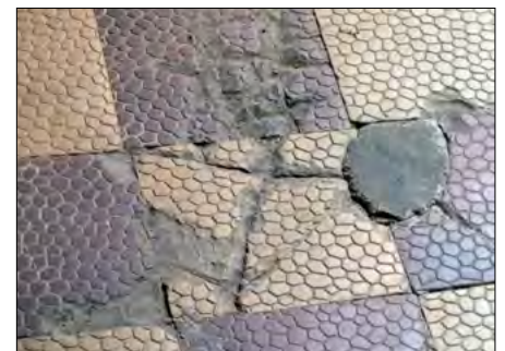
Risse und ausgebesserte Löcher an historischen Zementfliesen
