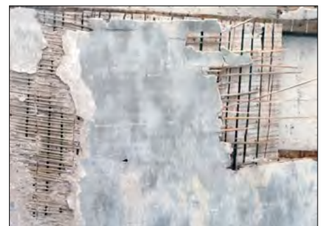
Zerstörter Rohrputz auf Holzschalung unter Holzbalkendecke
