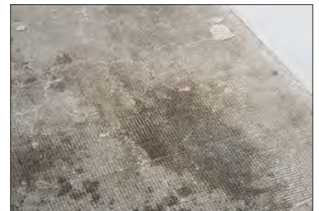
Geigelte Betonoberfläche mit Rissen und ausgebesserten Löchern
