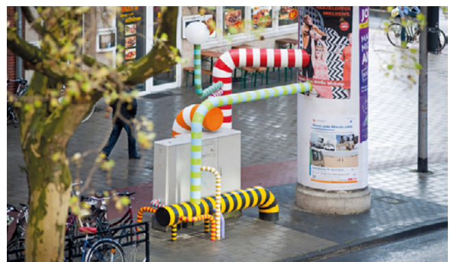
Gestalteter Schaltkasten „Goa“, durch die ISG Bahnhofsviertel finanziert
