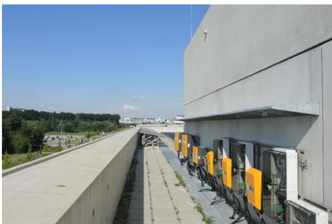
Bildquelle: com.X (Wechselrichter auf dem Dach der TH Ulm)
