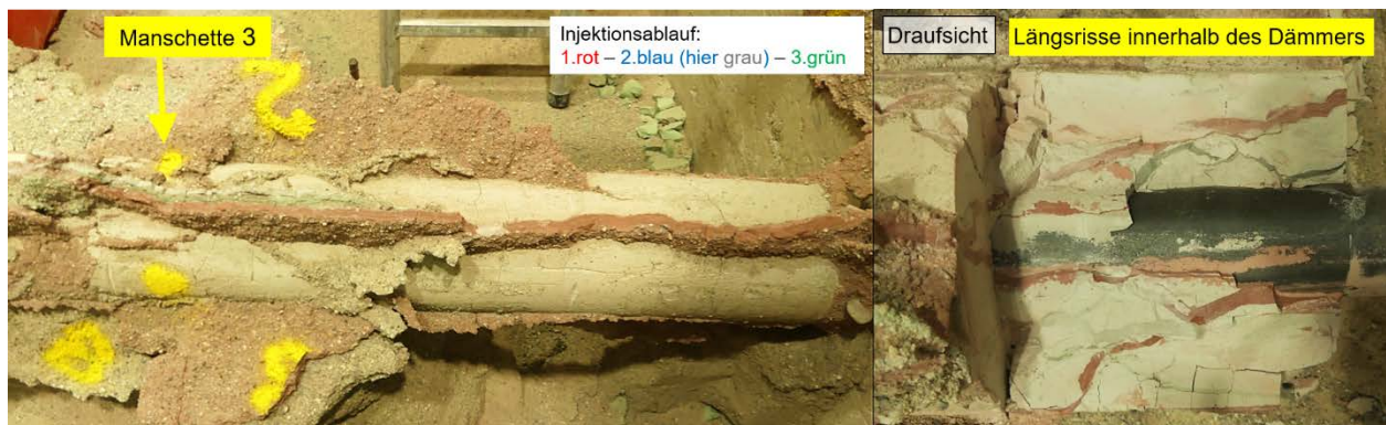
Abb. 4.34: links: Aufreißen der Dämmschicht entlang der Rohrachse (hier am Bsp. von Rohr 1)
