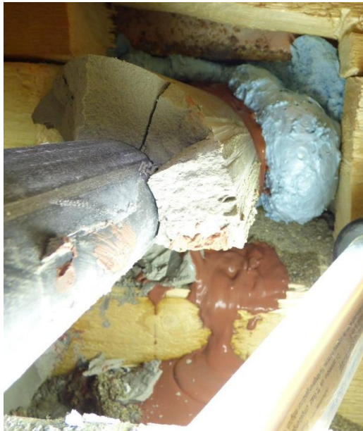
Abb. 4.16: Austritt von Suspension im Bereich der Durchführung des Manschettenrohrs an der Vorderwand des Versuchsaufbaus
