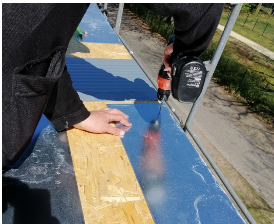
Bild 201 Befestigung der unteren Zinkbleche an den OSB-Holzplatten - dahinter gewelltes Unterlagsblech an der Verbindungsstelle
