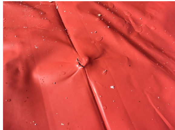
Bild 162 Beschädigung der Dampfsperre trotz darunter befindlichem Vlies
