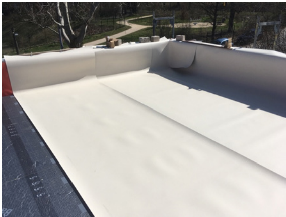
Bild 169 Lose Verlegung der FPO-Dachbahnen
