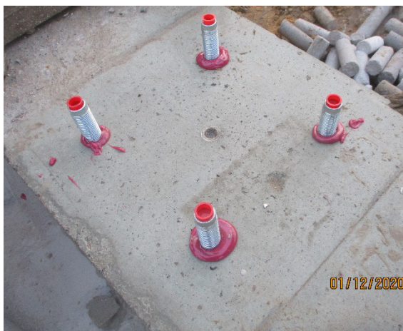
Bild 298 Aufmauern der KS-Pfeiler - Einkleben der Innengewindestifte der vertikalen Spannglieder an den Fundamenteckstein
