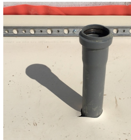
Bild 187 Durchstoßpunkt Dichtungsebene (Anschweißmanschette ist noch herzustellen, da es sich nicht um ein Standard Entlüftungsröhr handelte)
