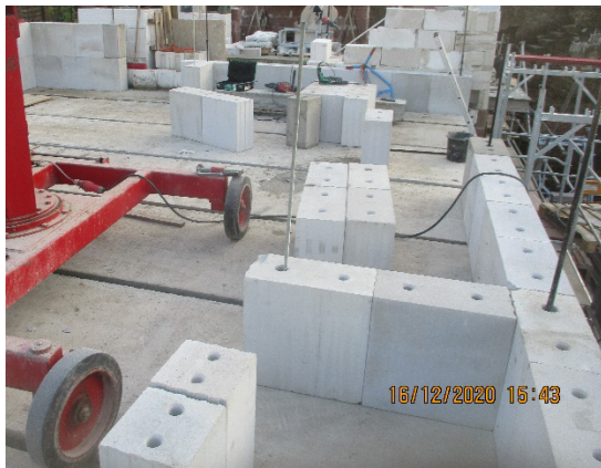
Bild 308 Vermauern Der KS-Wände im OG - Verlängern der vertikalen Spannglieder und Einfädeln der Quadro-Steine
