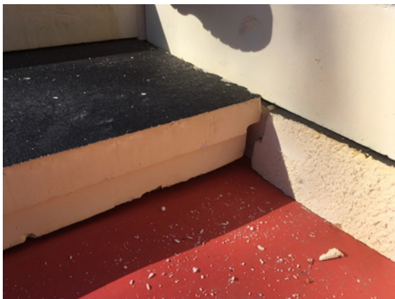
Bild 167 Deutliche Spaltbildung durch Unebenheiten in der Deckenoberfläche- Lösung: Stopfdämmung verwenden.
