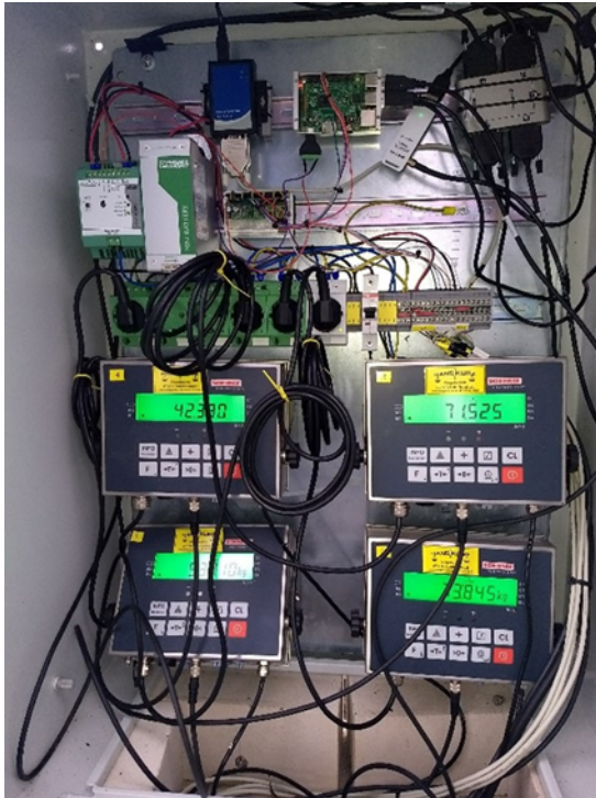
Abb. 8: Dezentrale Messstation, mit eingebauter USV.
