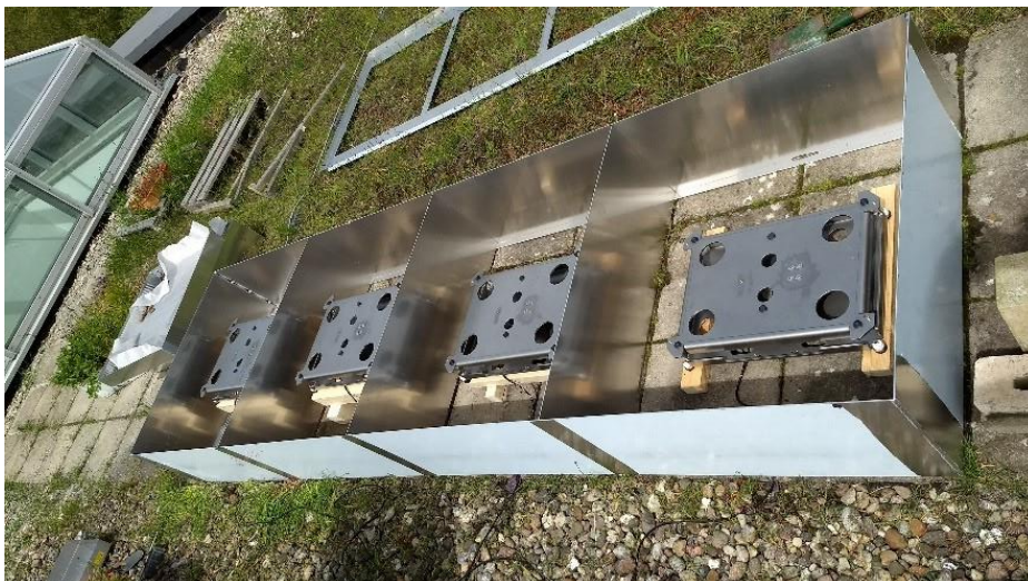
Abb. 13: Höhenausrichtung der Wägezellen, damit wird eine einheitliche Vegetationshöhe gewährleistet.
