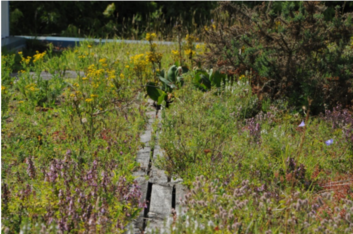
Abb. 4: Ehemalige Versuchsdachfläche in Tornesch. Die Vegetation hat fast 15 Jahre keine Pflege erhalten.
