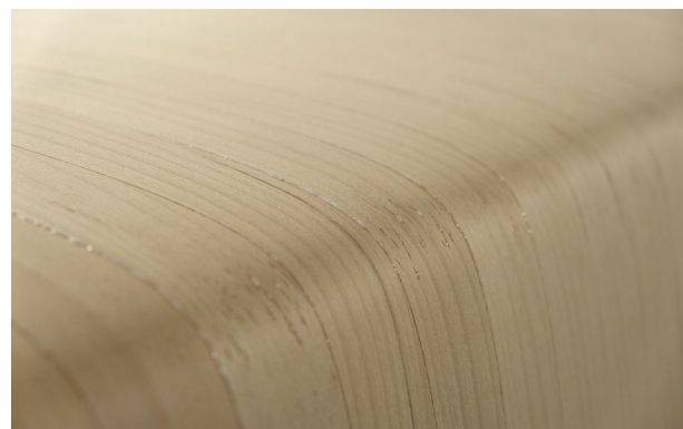
Abb. 85 Klebstoffaustritt zwischen den Fugen in den Eckbereichen
