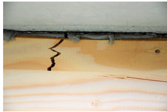
Abbildung 53 Probekörper B-TK-C3-FG-1 mit Biegezugrissen im Holz (Sekundärriss) und Öffnung der Fuge zwischen Holz und Beton
