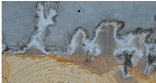
Abbildung 28 Ausblühungen an der Grenzschicht der zwischen Klebstoff C3 und Beton bei der Nassklebung
