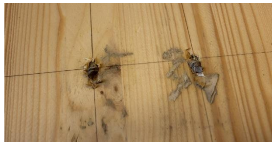
Abbildung 16 In der Verbundfuge gerissene Schrauben
