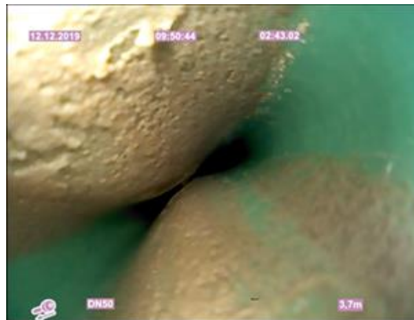
Abbildung 10 Innenansicht der Verformung 2 am Inliner (Höhe 1. OG)
