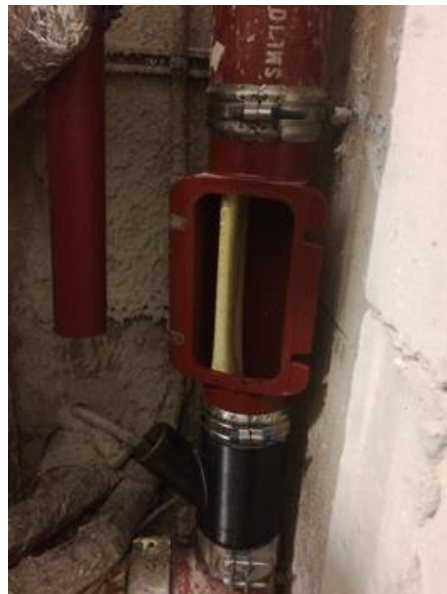
Abbildung 7 Verformung Inliner an Revisionsöffnung im 1. Obergeschoss
