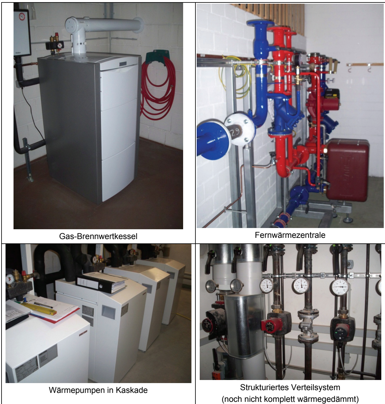
Abbildung 26: Best practice – Heizzentrale im Keller
