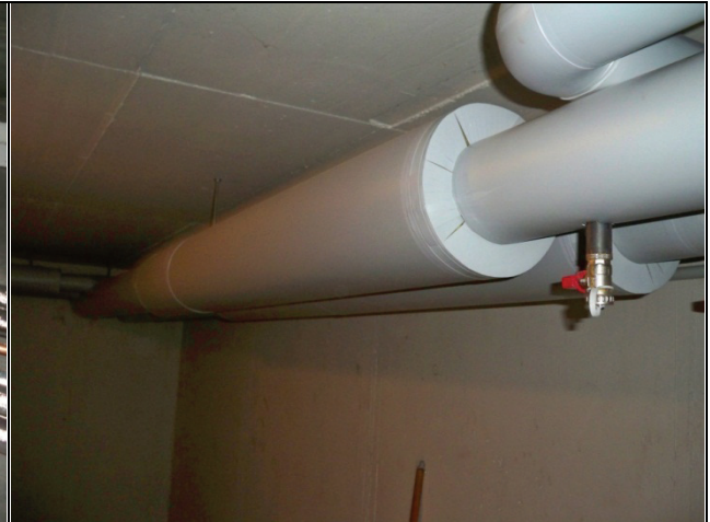
Verteilung im Kellergang (Kellerdecke von unten wärmegeklämmt)
