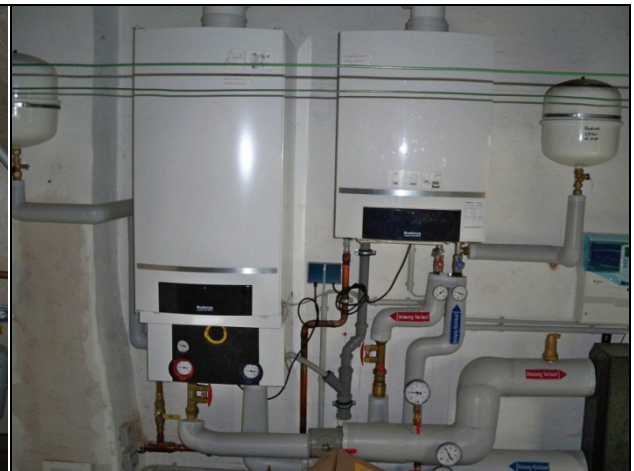
Gas-Brennwertthermen in Kaskade
