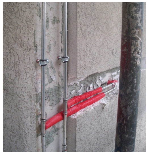
Steigleitung: außenliegend (im Zuge einer Effizienzhaussanierung nachträglich komplett wärmegeklämmt)
