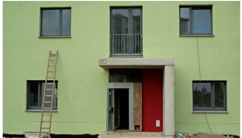
Foto: Arnt von Bodelschwingh Hauseingang eines Ersatzneubaus in Köln-Ostheim kurz vor der Fertigstellung
