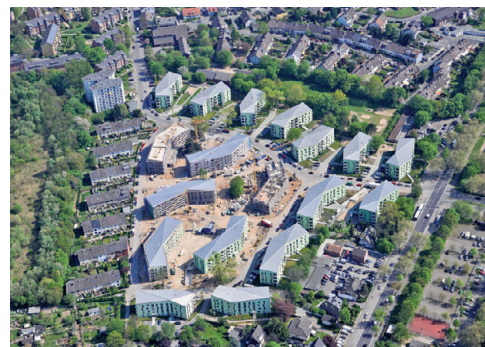
Foto: GAG Immobilien AG Luftbild der Siedlung Buchheimer Weg während der Baumaßnahmen
