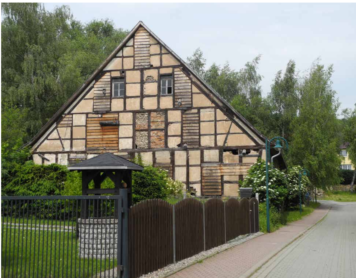
Die Alte Schmiede ist einer der Bauten des Dorfkerns, für die noch keine neue Nutzung gefunden wurde. Das Fachwerkhaus wurde aber zumindest vor dem weiteren Verfall gesichert. (statische Sicherung: bauhütte volkenroda)
