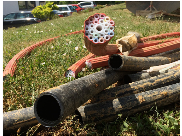
Ein Rohr mit vielen Möglichkeiten für Unternehmen und Privathaushalte – Baustelle der Laber-Naab Infrastruktur GmbH. Quelle: TÜV Rheinland Consulting GmbH
