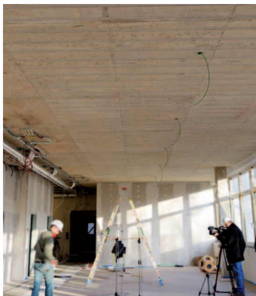
Abbildung 4: Betondecke mit Bauteilaktivierung und integrierten Schallabsorbieren aus Glasschaum
