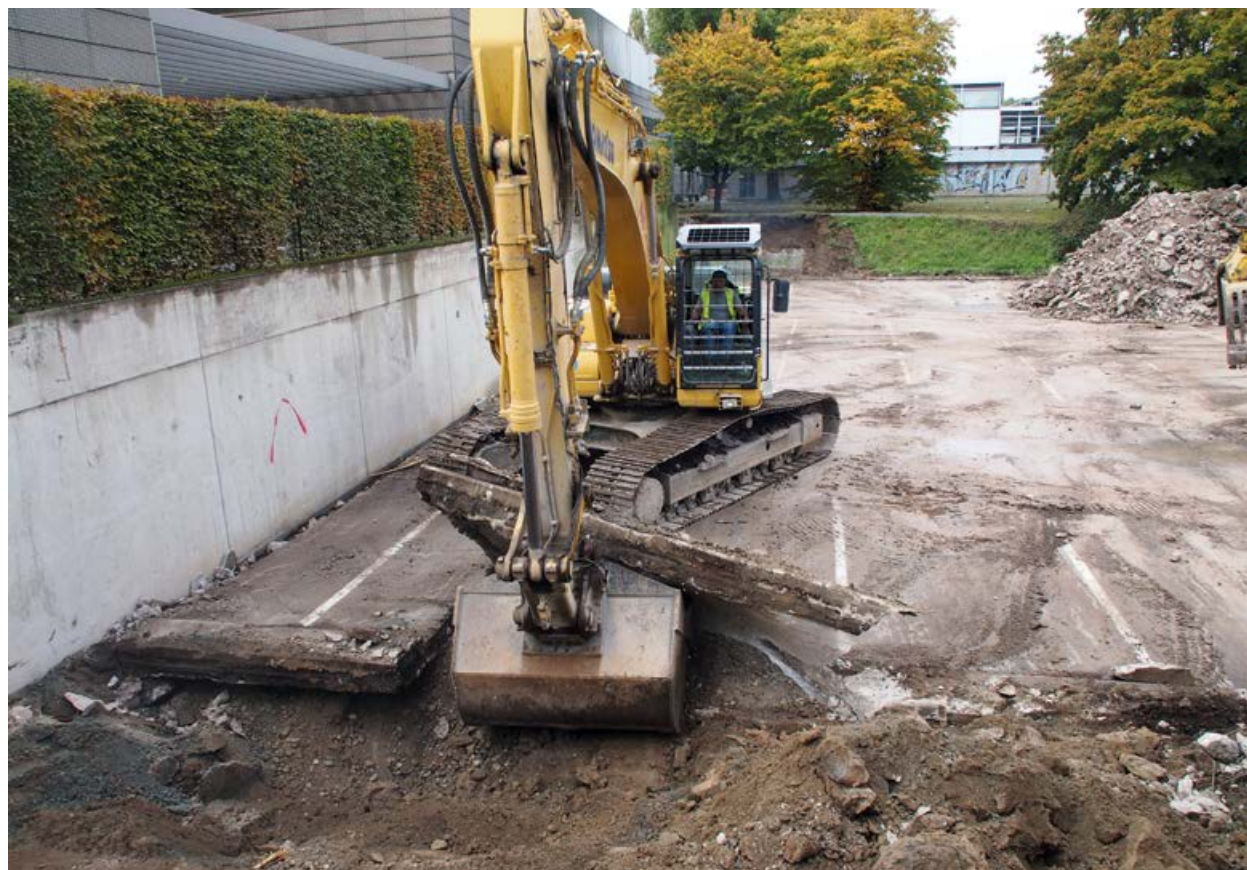
Untersuchungsobjekt 1 – Reißen der Bodenplatte
