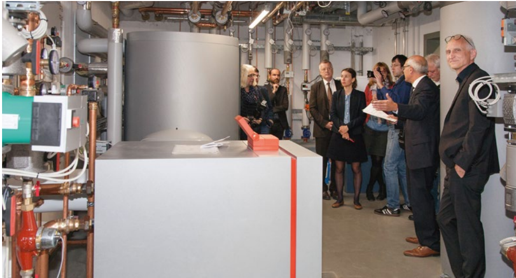
Abbildung 39: Führung durch die Wärmезentrale der Luise-Otto-Peters-Schule in Hockenheim während der Einweihung am 13. Oktober 2017.
