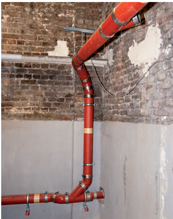
Abgehängte Leitungen an der Kellerwand
