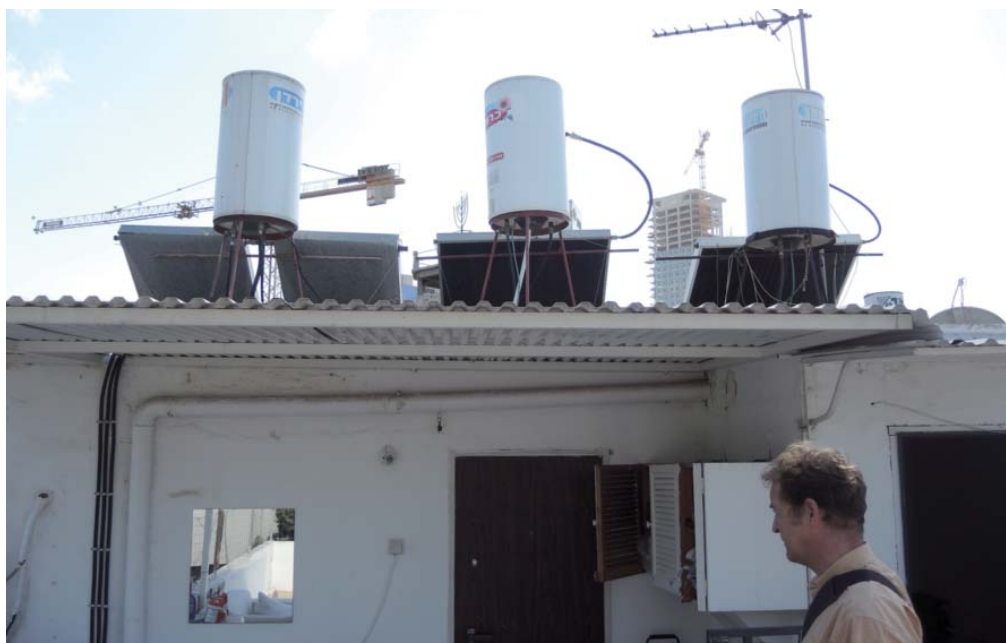
Abbildung 57: Thermosiphonanlagen auf dem Dach eines Mehrfamilienhauses, Tel Aviv, 2013
