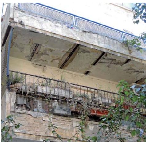
Abbildung 87: Bewehrungskorrosion Balkon, Tel Aviv, 2013
