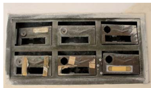
Abbildung 98: Briefkastenanlage Idelson Street 14, Tel Aviv, 2013
