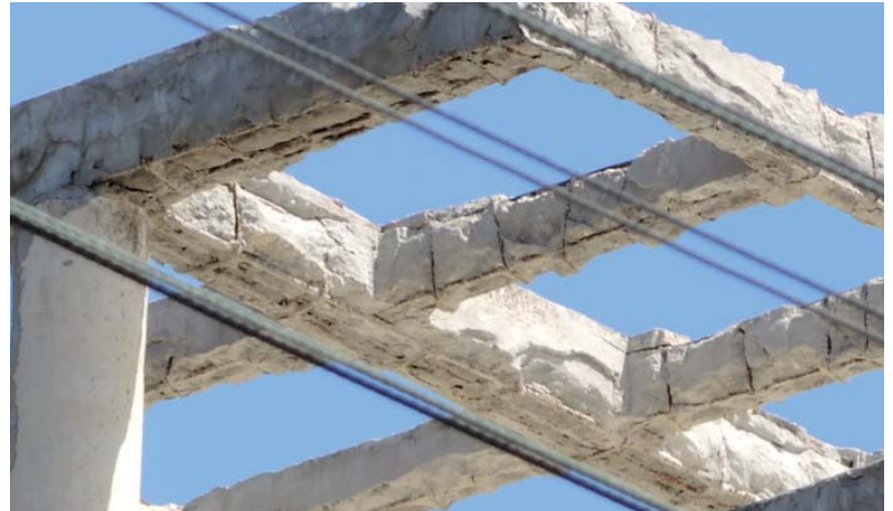
Abbildung 86: Vergrößerung des nebenstehenden Bildes, Bewehrungskorrosion Pergola
