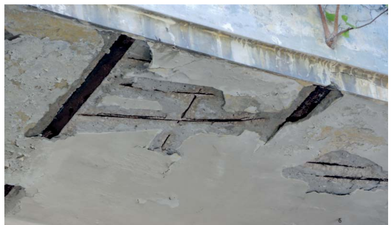
Abbildung 88: Vergrößerung des nebenstehenden Bildes, Bewehrungskorrosion Balkon
