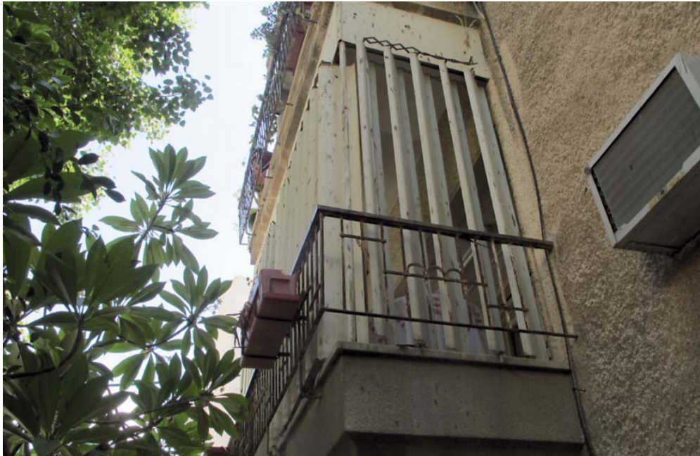
Abbildung 67: Wohngebäude, vermutlich 1940er-Jahre, mit typischem Putz und Lamellen an den Balkonen, Gordon Street, Tel Aviv, 2013
