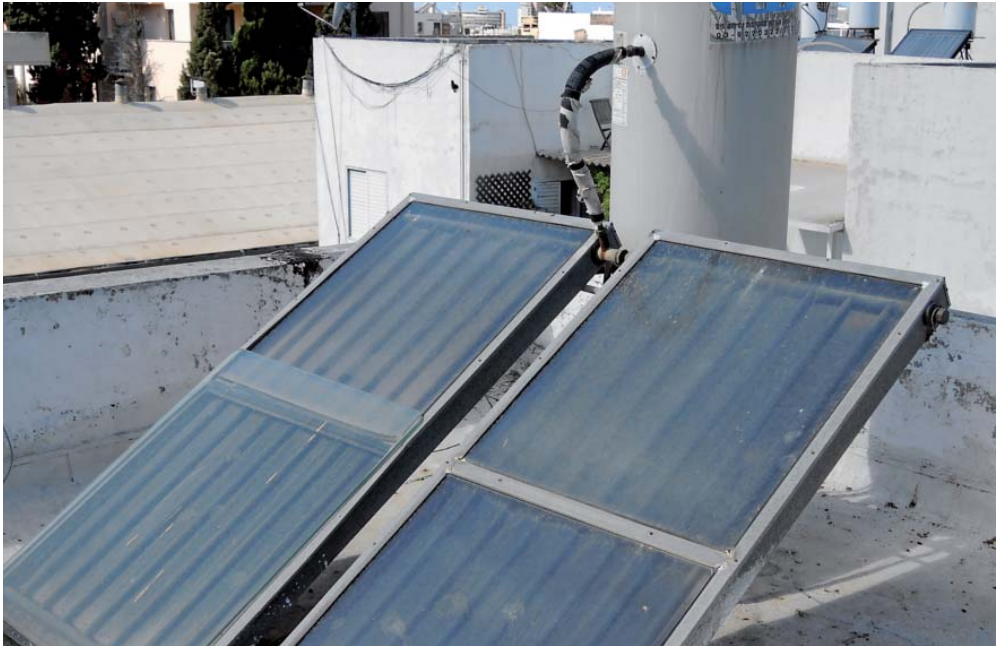
Abbildung 58: Thermosiphonanlage, Tel Aviv, 2013
