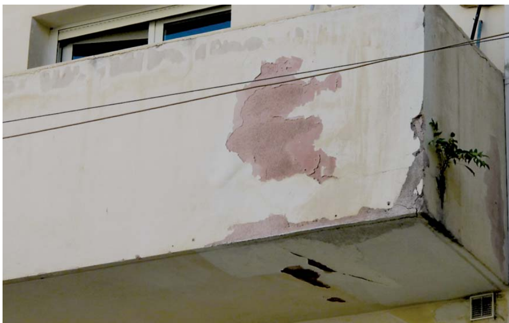
Abbildung 68: ursprünglich rotbrauner Putz wird unter dem abblätternden Anstrich sichtbar, Bereich Bellinson Street/Frug Street, Tel Aviv, 2013
