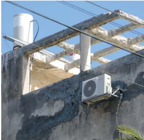
Abbildung 85: Bewehrungskorrosion Pergola, Tel Aviv, 2013
