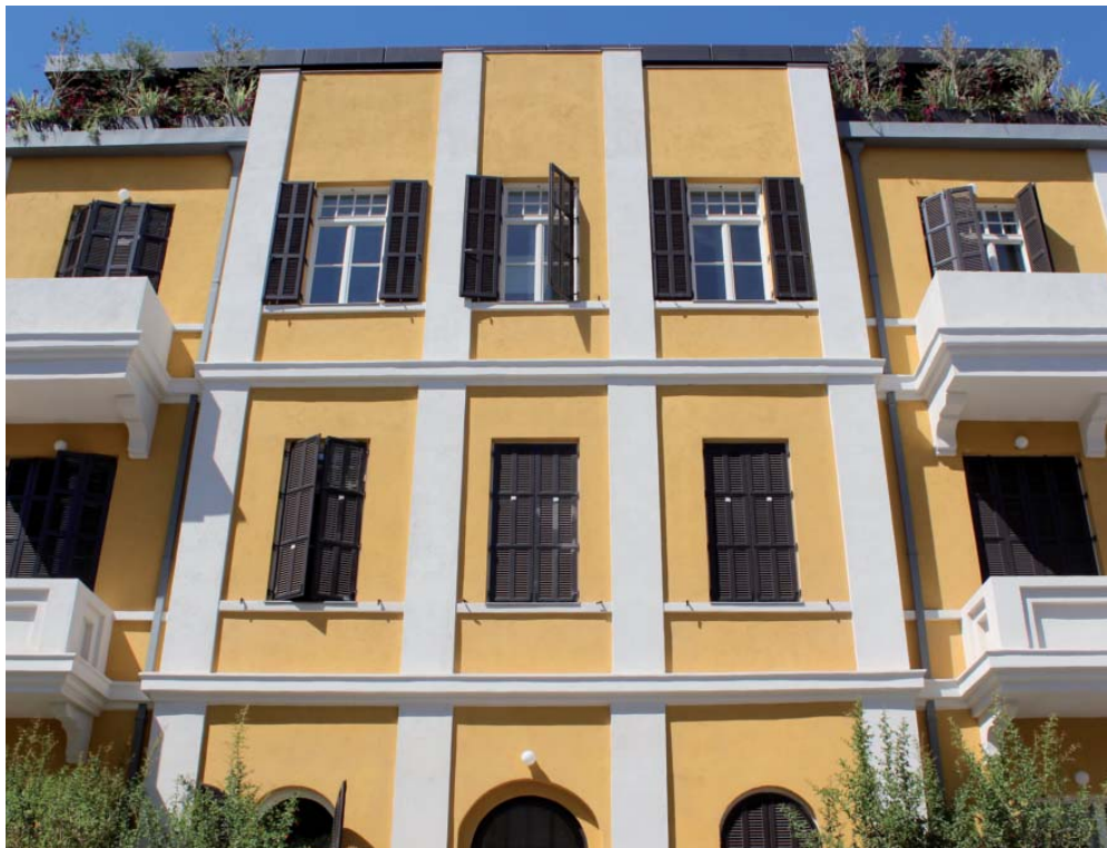
Abbildung 102: Aufstockung eines Wohngebäudes im eklektischen Stil um zwei Etagen, Ahad Háam Street, Tel Aviv, 2013. Das gesamte 2. Obergeschoss sowie das zurückgesetzte Penthousegeschoss wurden erst 2013 aufgestockt. Die Änderung ist lediglich an den reduzierten Formen der Balkonbrüstungen erkennbar.
