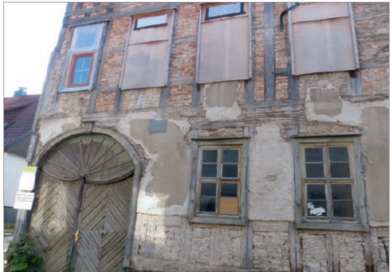
Mangelnde Investitionen in private Gebäude wirken sich auch auf die Attraktivität des öffentlichen Raums aus: leer stehendes Gebäude in Hildburghausen.
