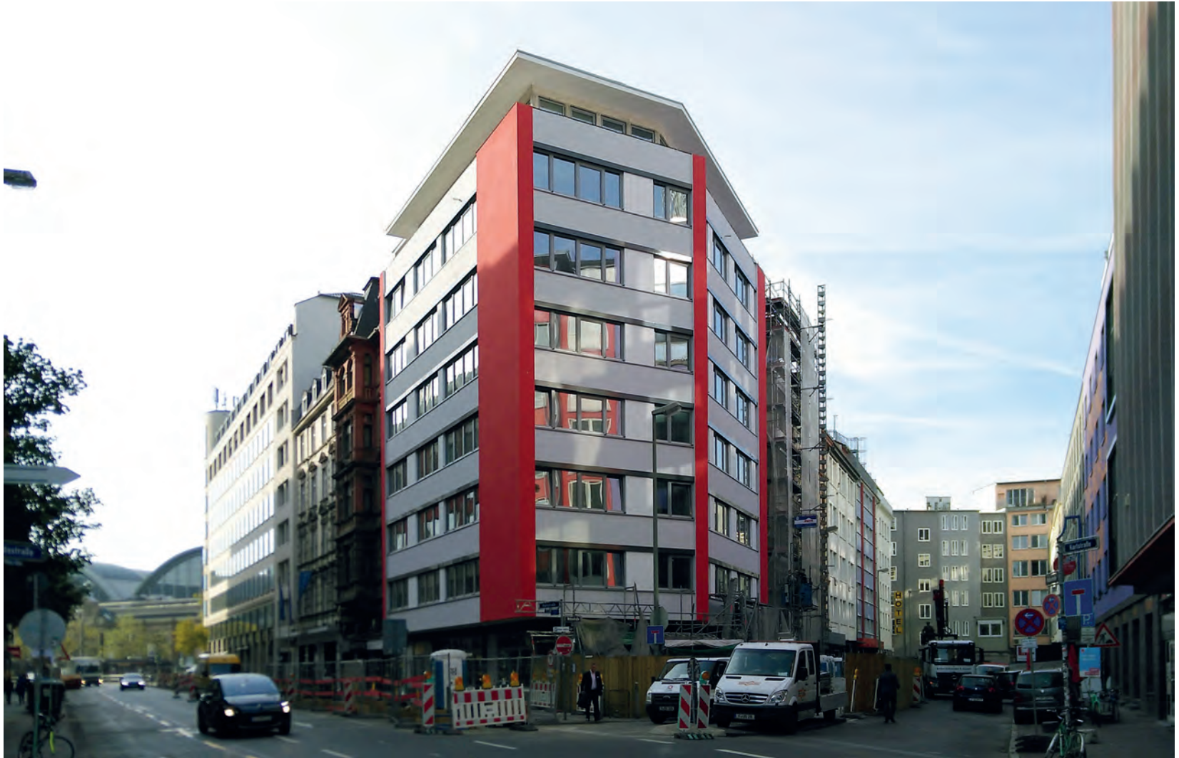
NiKa im Umbau, Architektur: Meides & Schoop Architekten, Foto: Ulrich Herding für Hausprojekt NiKa
