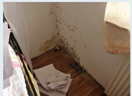
Im Dichterviertel gab es bauliche Missstände, die von außen nicht sofort erkennbar waren.
