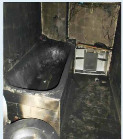
Städtebaulicher Missstand (Außenansicht) und Mängel im Inneren des Gebäudes
