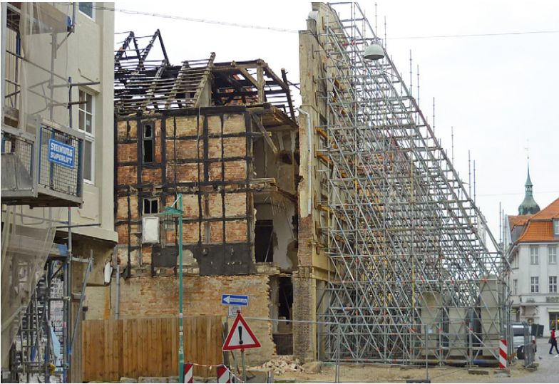
Mit Hilfe der Städtebauförderung können auch größere städtebauliche Missstände angegangen werden.
