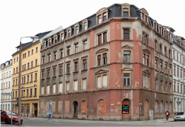
Einfache gründerzeitliche Altbauten in benachteiligten Lagen sind überdurchschnittlich von Leerstand und Verwahrlosung betroffen.
