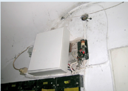
Im Gebäude festgestellte Mängel
