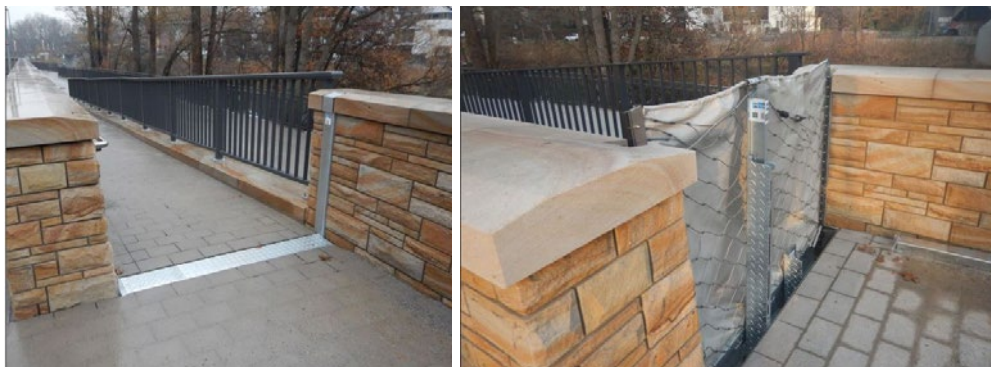
Folie-Stahl-Netz-Schutzwand „AquaWand“ an der Ems (Foto: Aquaburg)
