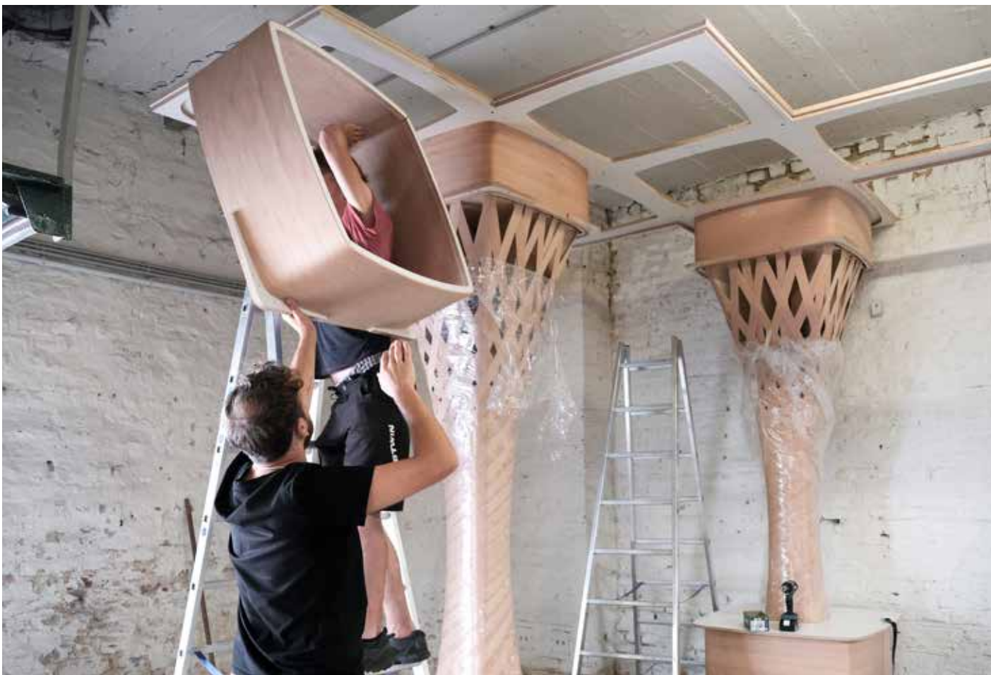
Die Leichtbaustruktur wird vor Ort assembliert: von Fundamenten für tragende Säulenelemente über Deckenverbinder bis hin zu Hohlkörpern als tragende Deckenelemente. Der Aufbau wird durch die Modularität vereinfacht. © EDEK, Universität Kassel
