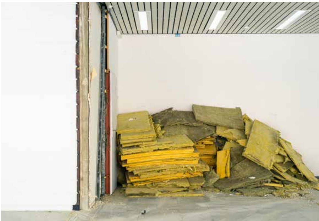
Der Umbau im Erdgeschoss war ein Rückbau zu einem großen Universalraum. © David Herrmann
