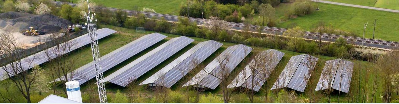
Die Photovoltaik-Anlage ist ein fester Bestandteil der eigenerzeugten Energie in Haßfurt | Quelle: Stadtwerk Haßfurt GmbH (Instagram/@stadtwerk_hassfurt)
