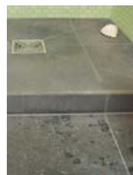
Stufe auf die Dusche Foto: PG
