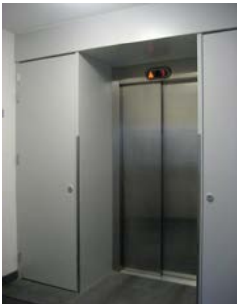
Zugang zu den privaten Stauschränken Foto: EM
