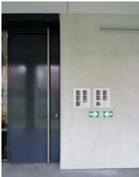
Hauseingangstür mit zus. Schlüsselschalter Foto: EM
