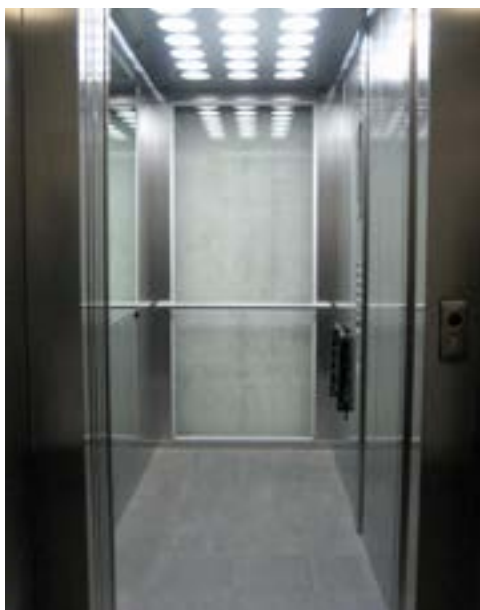
Aufzugskabine mit Festverglasung Foto: EM
