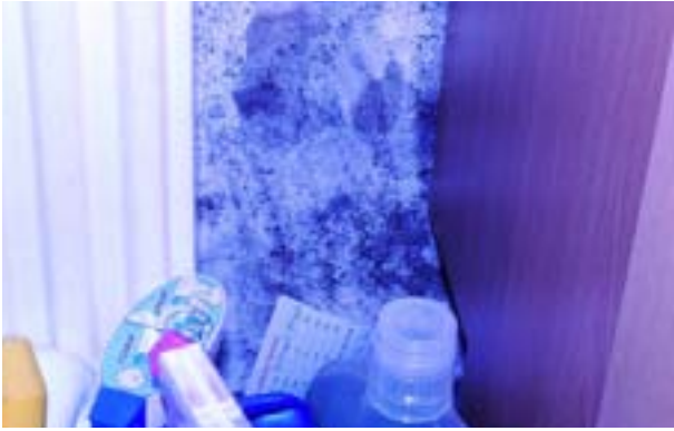
Abb. 89 Schimmelwachstum an einer Außenwand (vermutlich Cladosporium herbarum ) in Verbindung mit unzureichender Belüftung hinter den Unterschränken einer Einbauküche. Chemische Reinigungsmittel können das Problem nicht dauerhaft lösen. (Fotos: Licha/Wallner/Ziegler)
