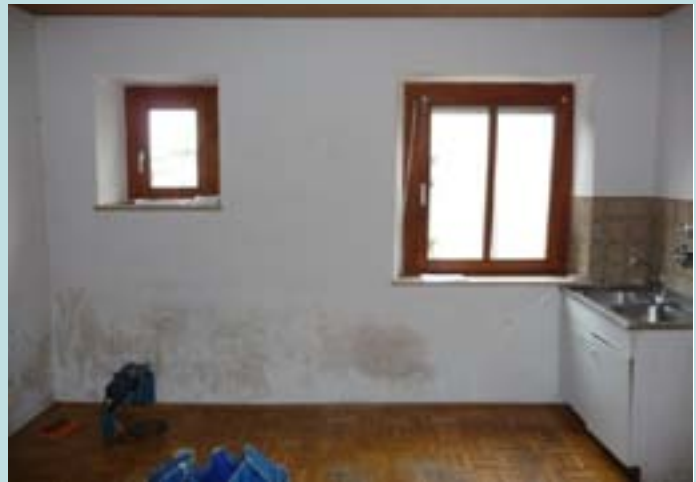
a) Innenansicht der nordöstlichen Außenwand der Küche, großflächig mit Schimmel bedeckt im unteren Bereich
