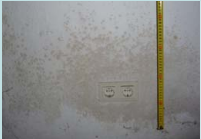
b) Detail aus a) Vermutlich waren hier Schränke oder eine Eckbank aufgestellt, sodass nur eine unzureichende Luftzirkulation vorhanden war
