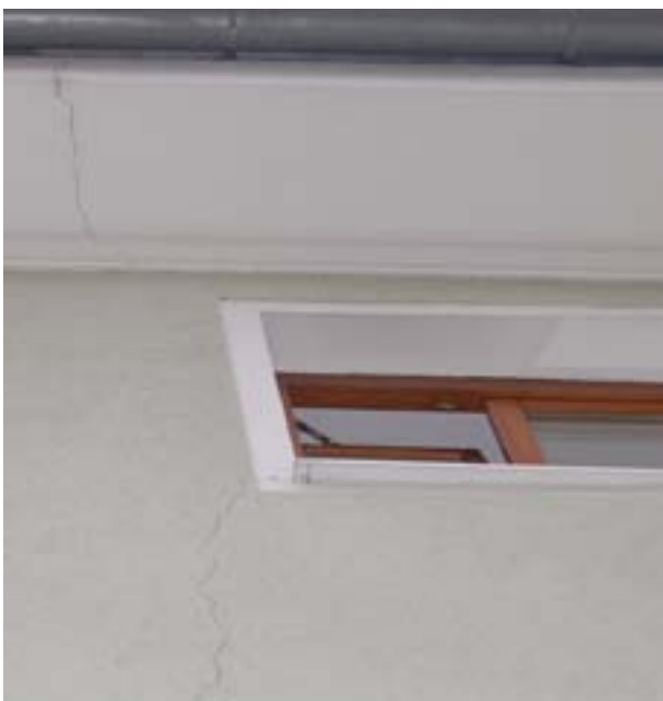
Abb. 78 Dehnungsriß (konstruktiv bedingter, vertikal verlaufender Riss vom Ringbalken abwärts) (Foto: Semmler/Cemedanov)
