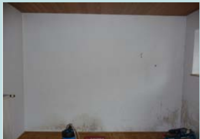
c) Innenwand der Küche zum Treppenhaus, im unteren Bereich mit Schimmel bedeckt, vermutlich ebenfalls durch vorgestellte Möbel hervorgerufen
