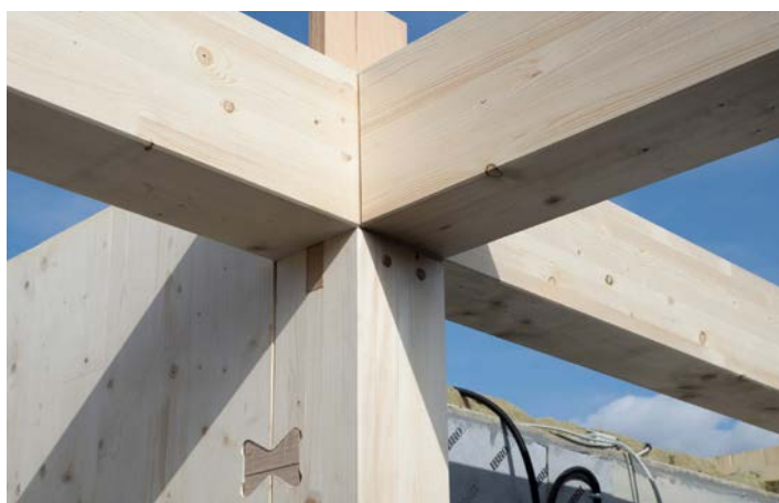
Abb. 146 Kennzeichen des Projektes sind reine Holz-Holz-Verbindungen, die eine schnelle Montage erlauben. [© DGJ Architekten]
