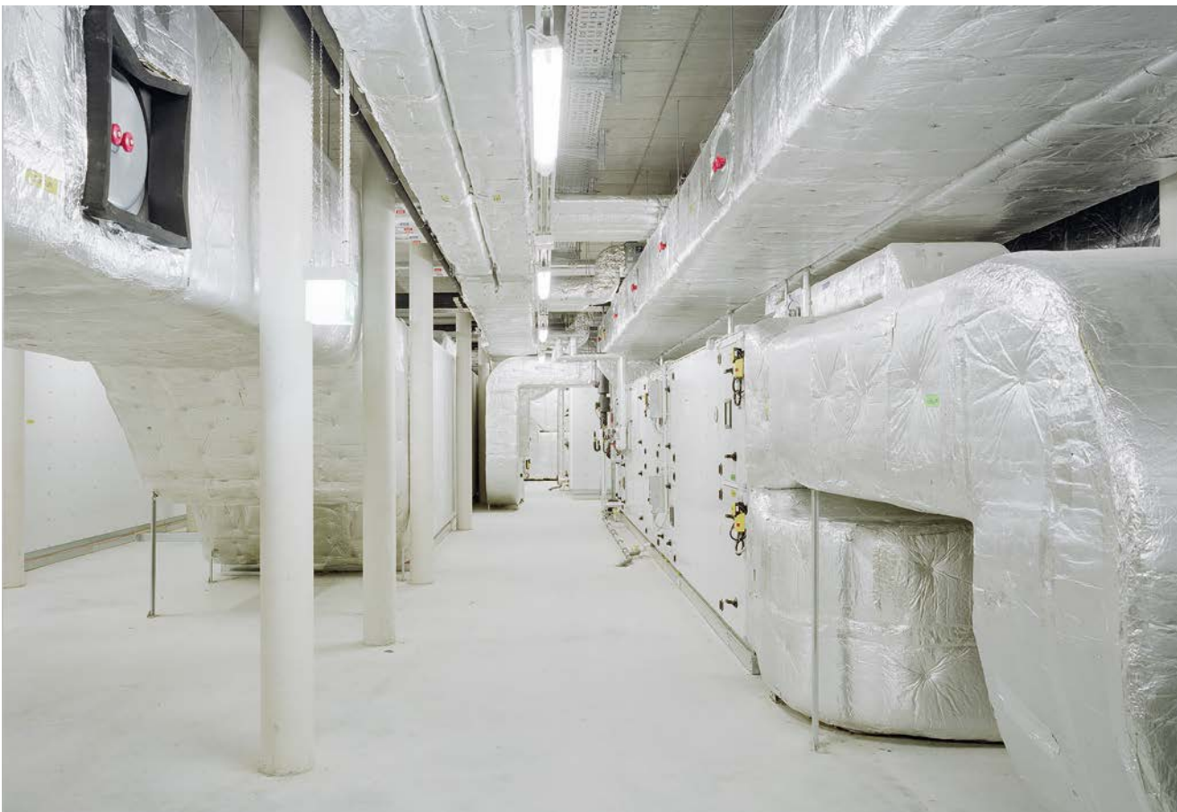
Abbildung 16: Schmuttertalgymnasium Diedorf, Lüftungszentrale [Quelle: Schelz, Lanz, PK Odessa]
